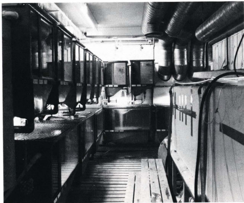
Karanteneanlegget i akvariets tekniske avdeling.
