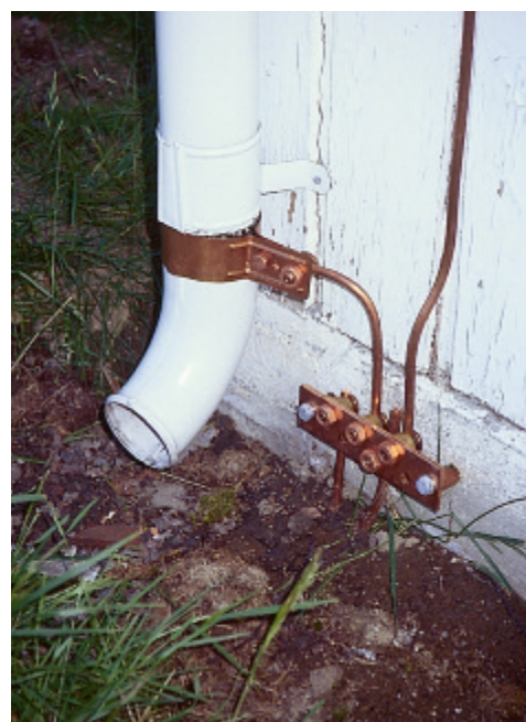
Under: Et viktig forebyggende tiltak kan være å sikre bygningen mot brann som følge av lynnedslag. Her er lynavleder knyttet til taknedløpet og ført ned i jord.
