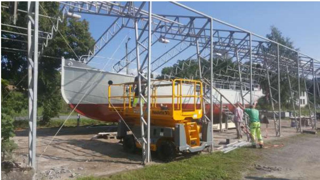
Ferdig utvendig maling, demontering av arbeidshall for å komme til med kran.
