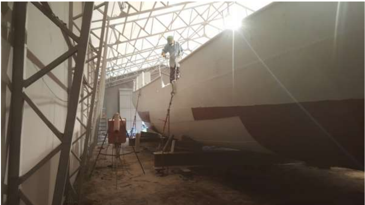
Malingsdugnader i løpet av sommeren. Utvendig og innvendig priming og toppstrøk. Vannlinje markert.
