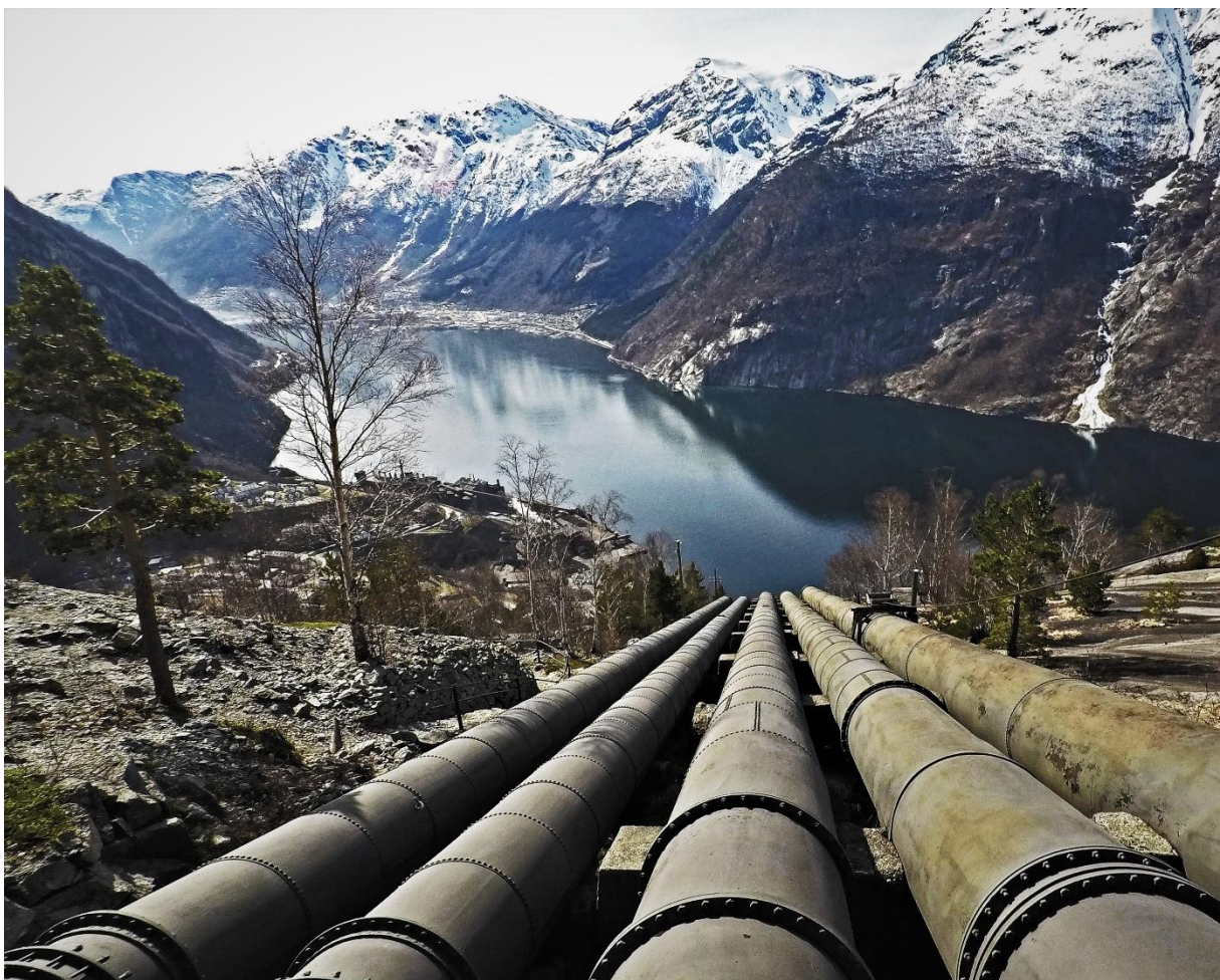
Vasskrafta er ein føresetnad for industristadane Tyssedal og Odda, og kjernen i NVIM sitt arbeid. Her er røyrsgata i Tyssedal kraftverk, sett frå Lilletopp. Foto: Knut Markhus
