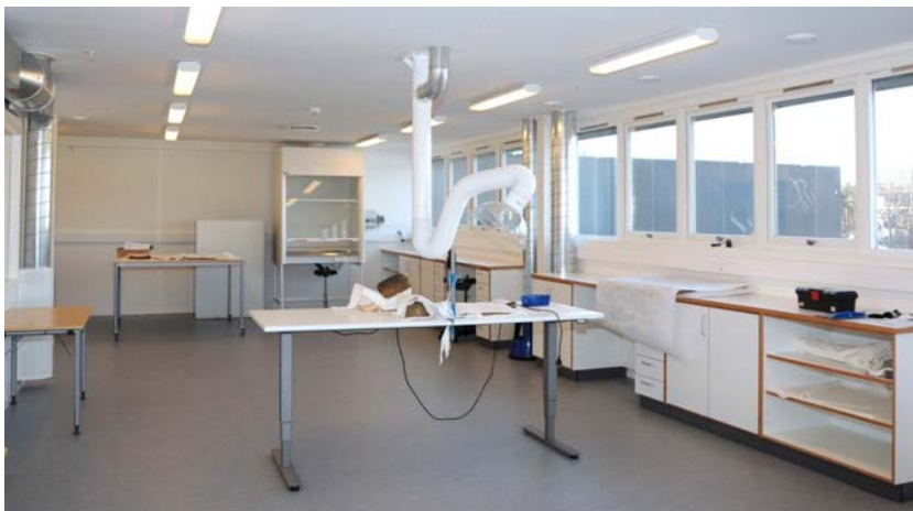
Punktav sug og avtrekksskap i konserveringsatelieret for papir og tekstil. Foto: M. Wolday, Vestfoldmuseene IKS.
