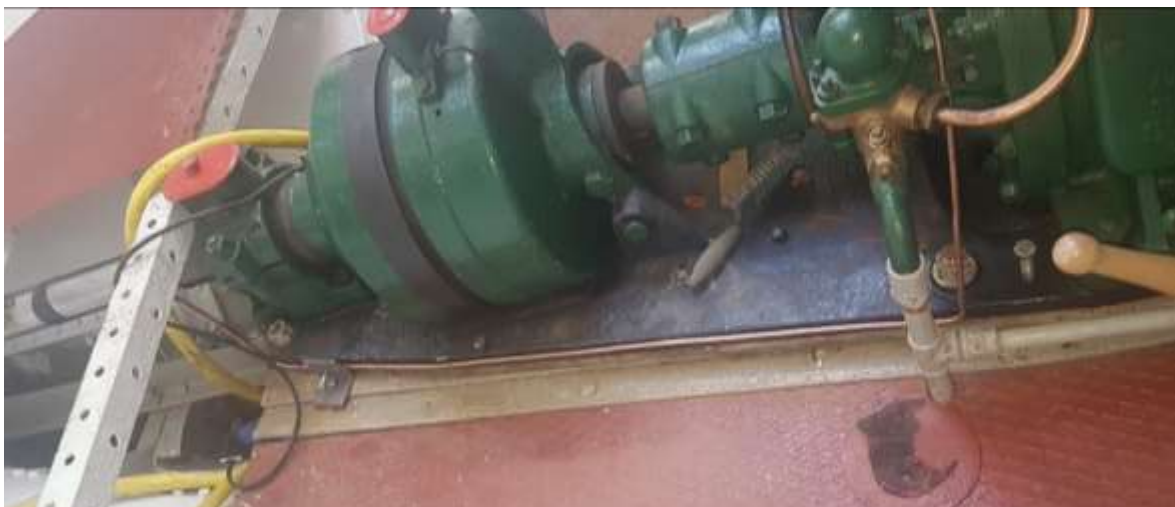
Drivstoffsystem montert, kobberrøret er lagt langs motorblokk for å minimere skade/brudd. Til venstre i bildet er dieselfilter montert delvis skjult under vinkel for dørkeplate. Gul slange er midlertidig brukt for lensepumpe. Foto: Lennart Bildengjerdningen
