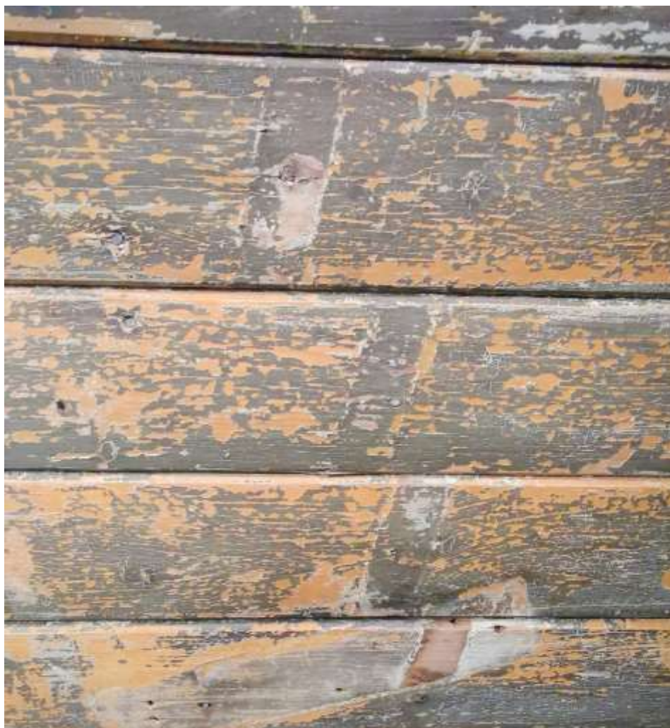
Himlingsbord over køyer babord side. Den gule fargen er tidl. grunning
