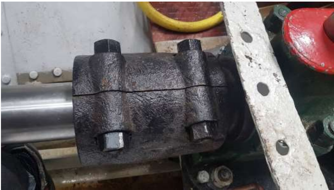
Motor og gir er koblet sammen med propellaksling. Foto Lennart Bildengjerdningen
